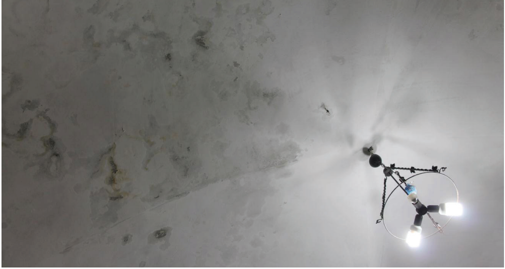
سقف بيت في النبي صموئيل تجتمع عليه العفن بسبب الرطوبة. صورة التقطتها "الحق" © 2017.
